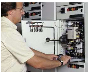
Lắp ráp một ngăn rút kéo 200kW Insertion of a 200 kW drawer
