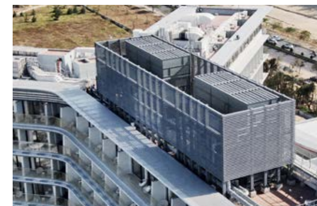
Hệ thống HVAC | HVAC System
