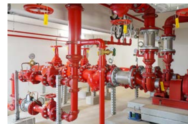
Hệ thống PCCC | Fire Protection System
