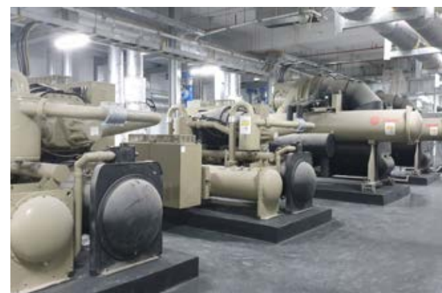
Hệ thống HVAC | HVAC System
