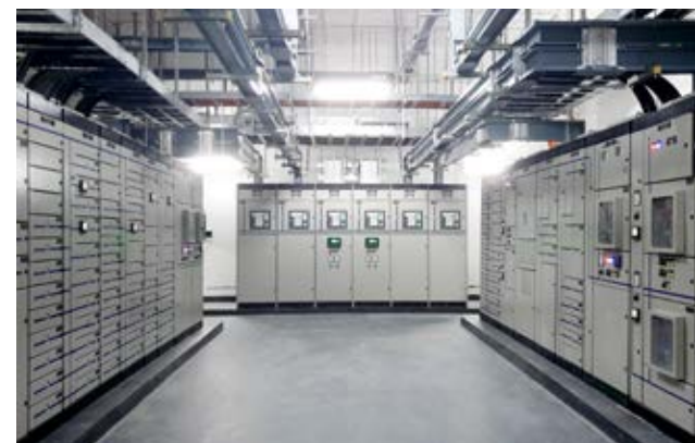
Hệ thống Điện | Electrical System
